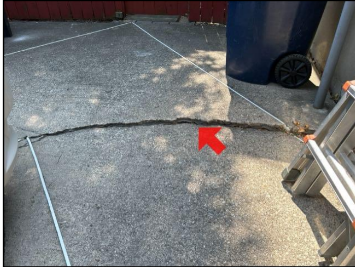
Uneven (trip hazard)
